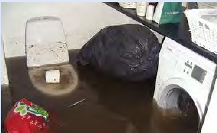
Kælderoversvømmelse med "beskidt" vand.
